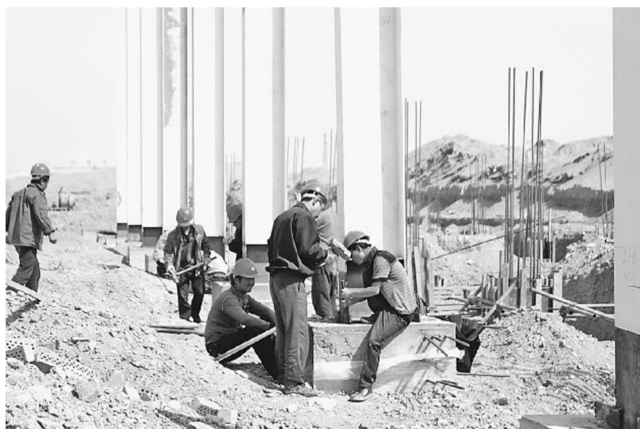
陕汽乌海新能源专用汽车有限公司坐落在千里山工业园区,规划用地1100余亩,总投资10亿元。项目分两期实施,到年底完成总装单元建设,并达到2万辆装配能力;2014年完成全部建设,实现5万辆产能目标。图为9月7日工人在进行厂房钢结构安装。(于虎成 摄)
